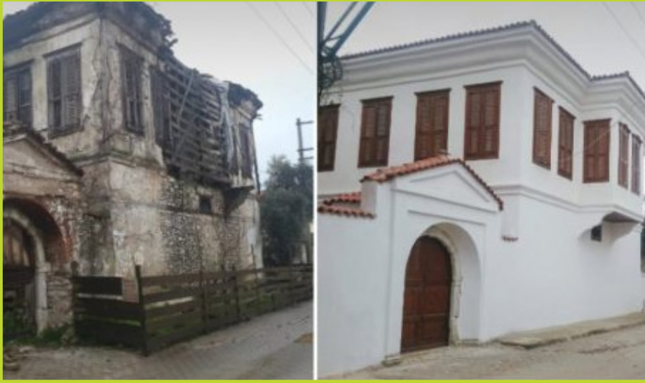
Muğla İli Ula İlçesi Alparslan Mahallesi Muammer Ağa Konağı ve Müştemilatı Restorasyonu
